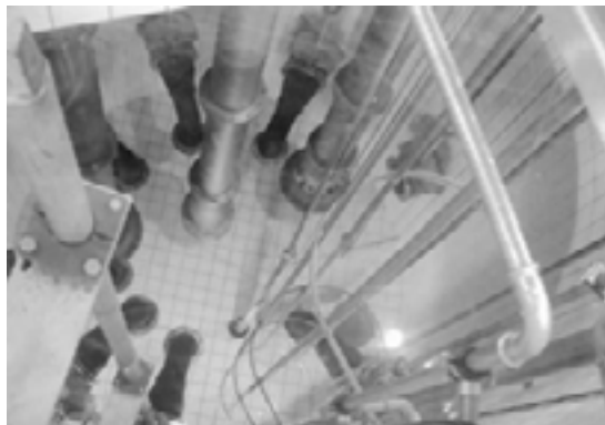
Filterhalle des Wasserreservoirs Könizberg
