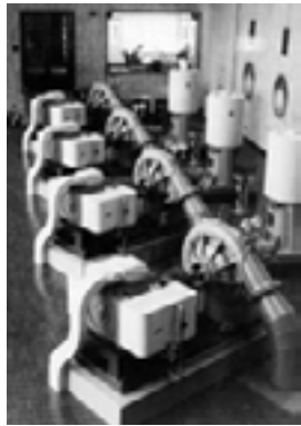
Pumpenhalle der Zentrale Schönau
